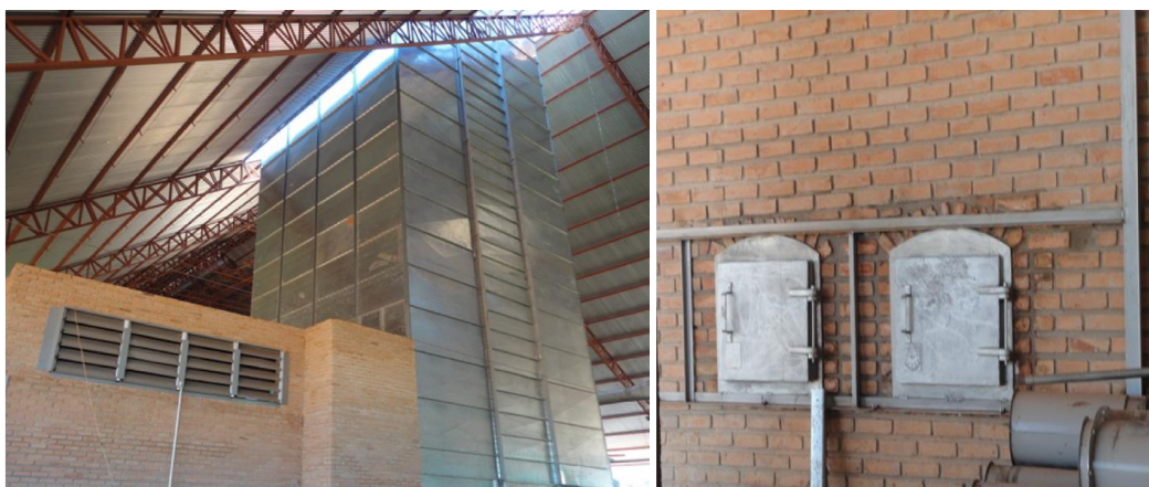
Figura 5 – Estrutura Física: Secador de grãos e caldeiras a lenha Fonte: Própria (2014).
