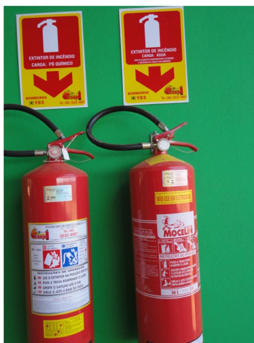
Figura 9 – Estrutura Física: Extintores de incêndio Fonte: Própria (2014).
