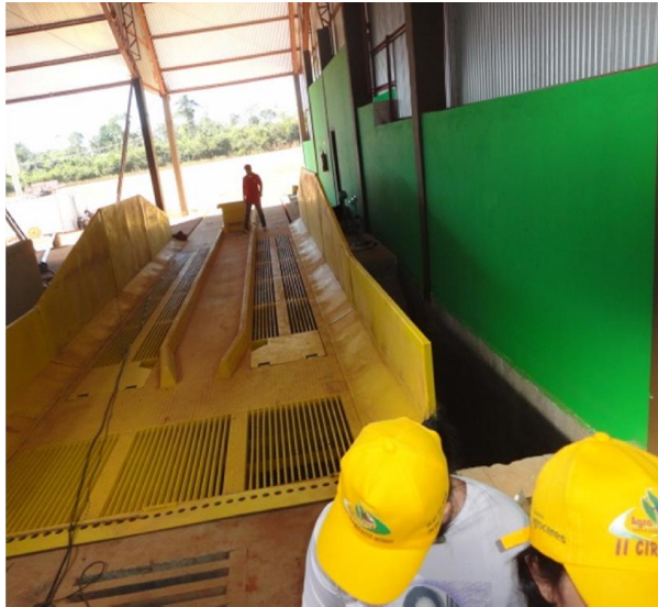
Figura 2 – Estrutura Física: Descarga Fonte: Própria (2014).
