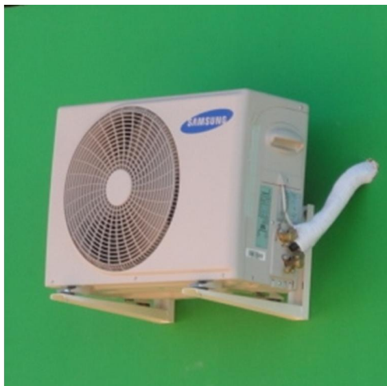
Figura 11 – Climatização do ambiente do setor Administrativo Fonte: Própria (2014).
