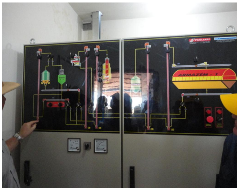
Figura 8 – Painel de controle elétrico. Fonte: Própria (2014).
